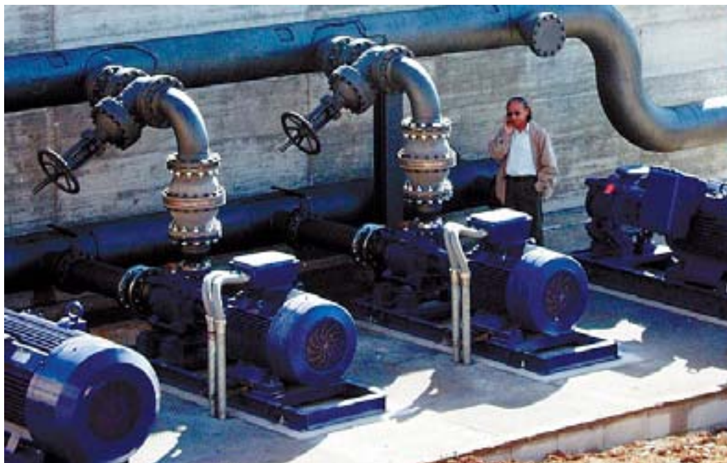
Un impianto idrico
